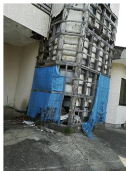
駅近くの崩壊した建物
